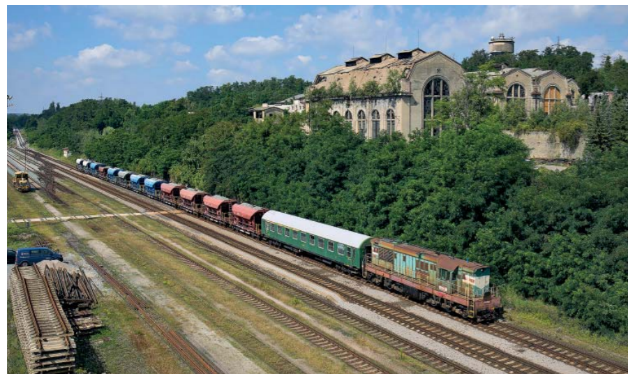
V srpnu 2021 probíhaly opravné práce mezi Kladnem-Dubí a Kralupy nad Vltavou. Návoz štěrku z Kamenných Žehrovcí ve výsypných vozech zajišťovala opět téměř muzejní lokomotiva Čmelák. Industriálně nostalgickou siluetu stanice Kladno-Dubí dotváří nad kolejíštěm budova bývalého dolu František Josef, jehož těžní jáma dosáhla hloubky přes 360 m a těžba v něm byla ukončena po roce 1990
